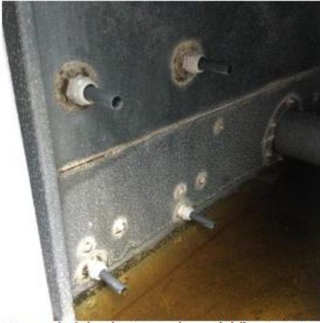
Opvangbak koelwater + doseerleiding BCDMH
